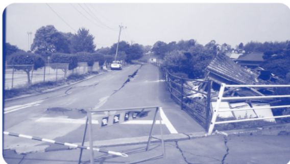
▲亀裂の入った道路
